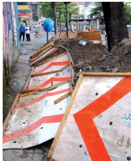
Acidentes em bueiros demonstram falha na manutenção
