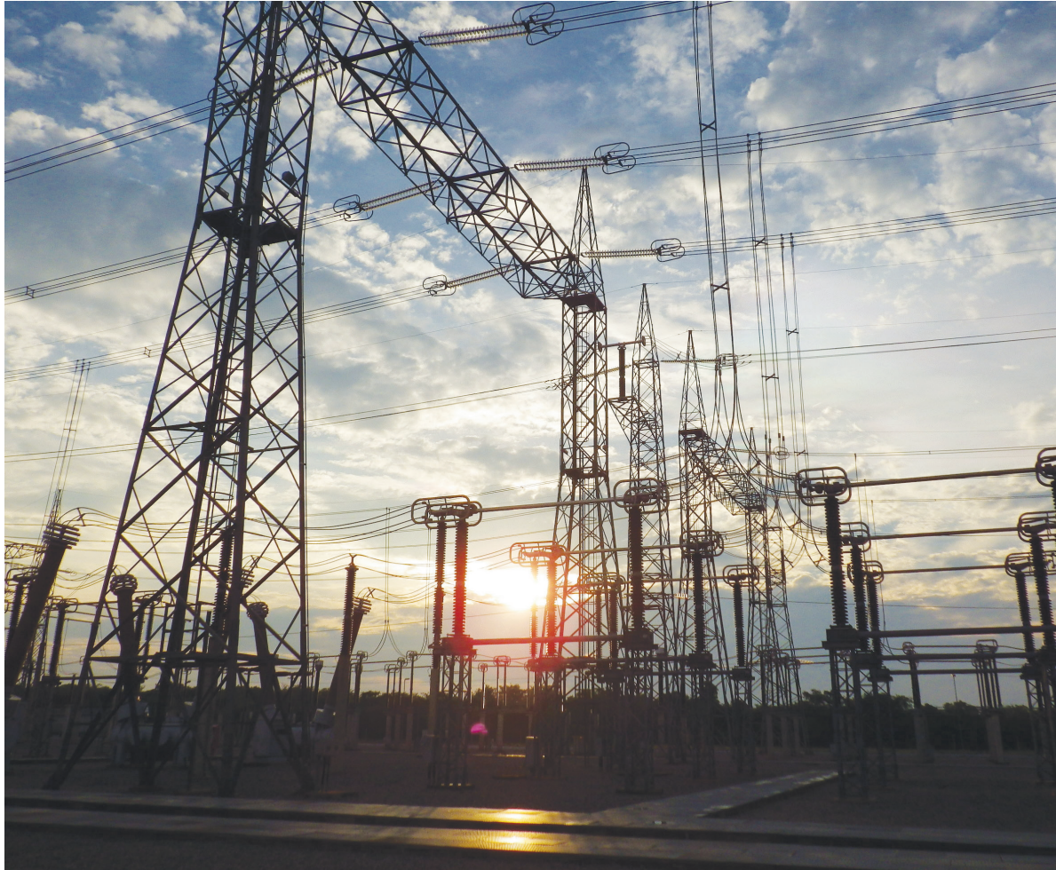
Subestação de Gurupi, no estado de Tocantins
